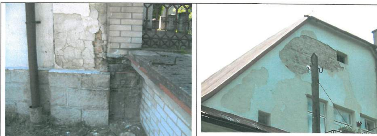
Foto. 3. Tynk na elewacji – widoczne uszkodzenia
