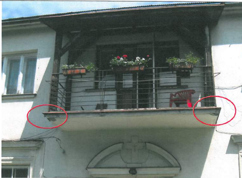
Foto. 7. Uszkodzone naroża balkonu na elewacji wejściowej budynku
