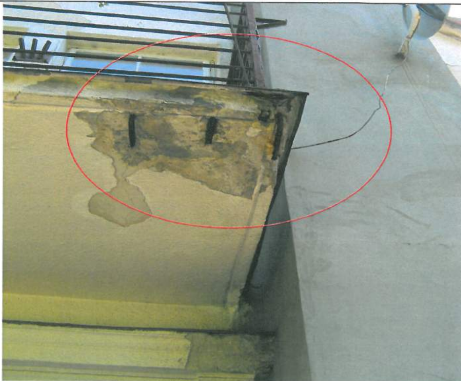
Foto. 8. Uszkodzone naroża balkonu na elewacji bocznej budynku
