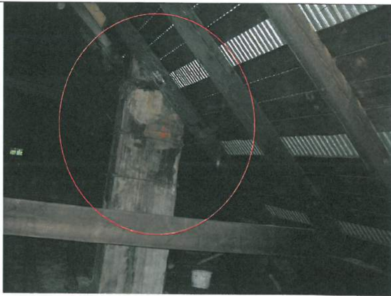
Foto. 9. Konstrukcja dachu koło komina uszkodzona w wyniku pożaru
